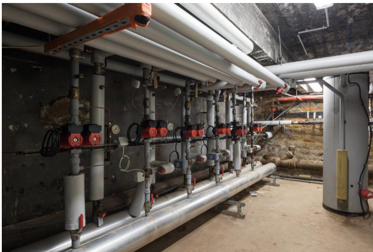
Sous-sol : réseau de chaleur.
