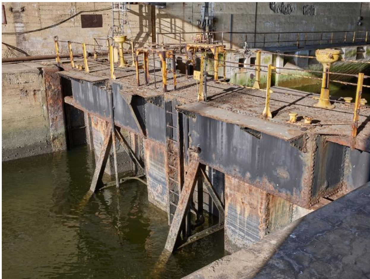
Vue du bateau-porte fermant le bassin depuis l'extérieur avec ses commandes de pompes et de vannes de ballast
