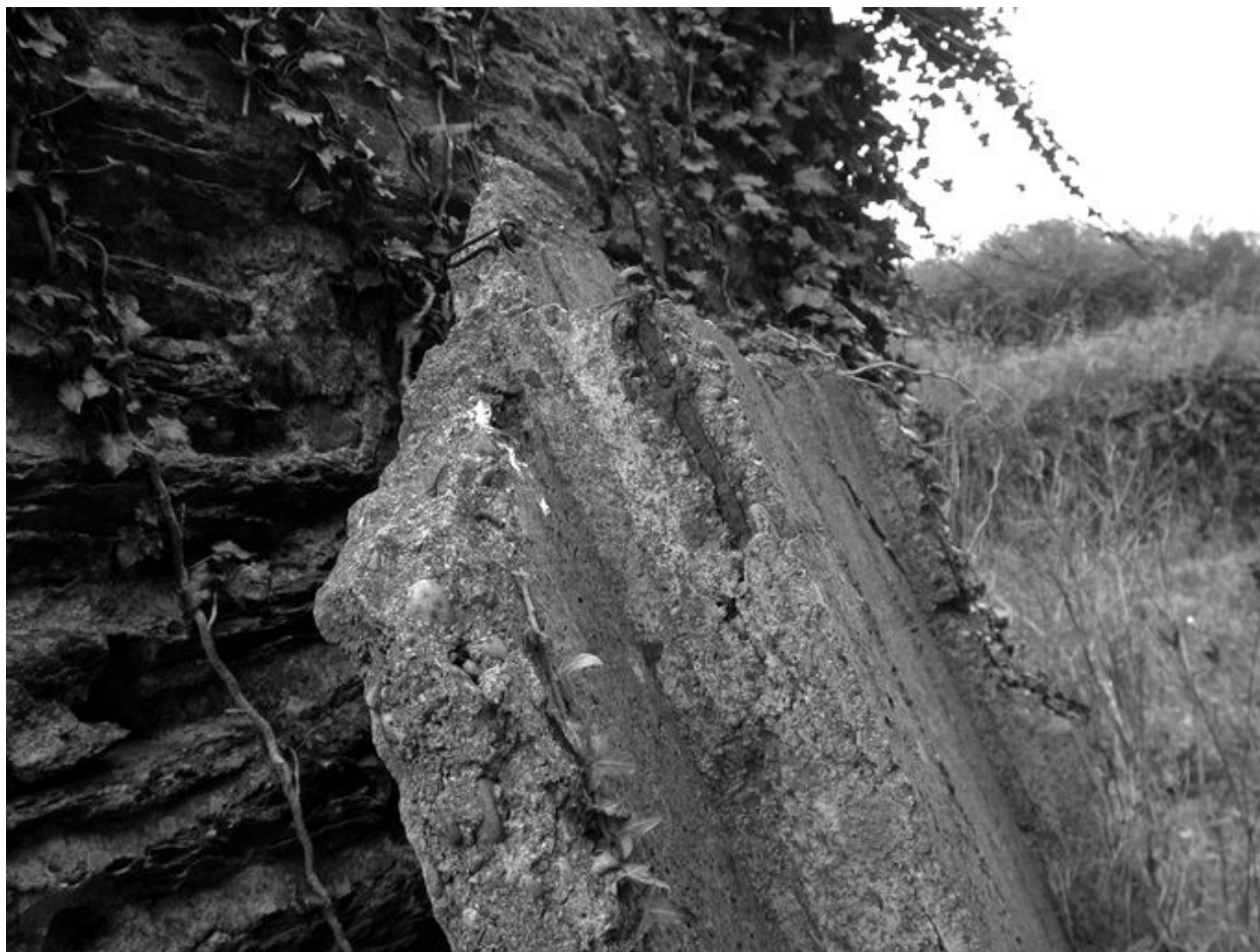
Roscanvel, pointe de Cornouaille : tour-modèle n° 1, vestiges du pont dormant en béton
