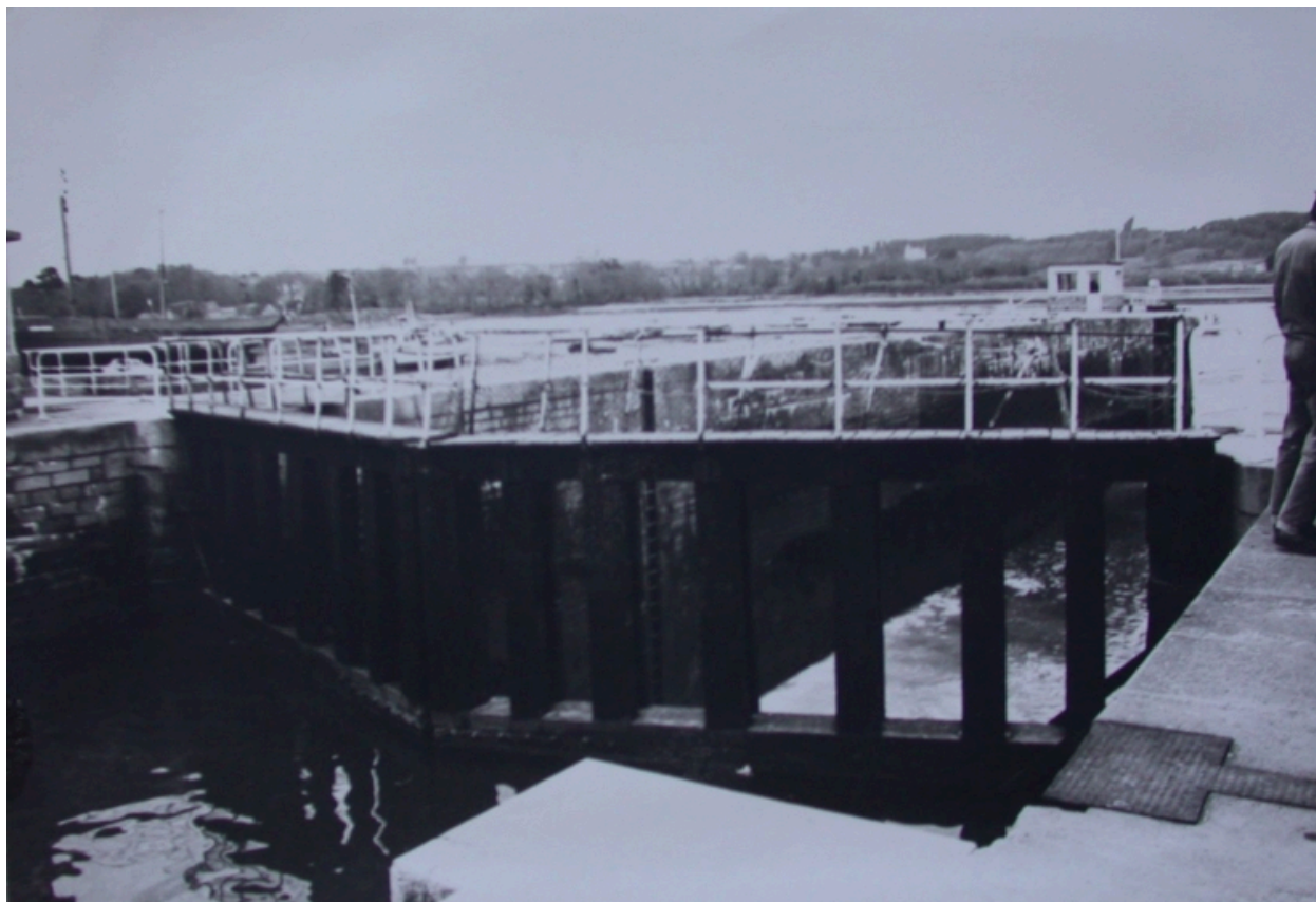
Vue de l'état de la porte amont, à la fin des années 1980 (non daté, photo Ponts-et-Chaussées)
