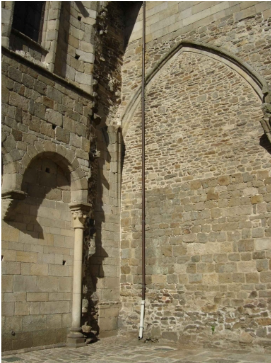
Bras de transept Sud : angle de l'élévation sud de la nef et du mur ouest
