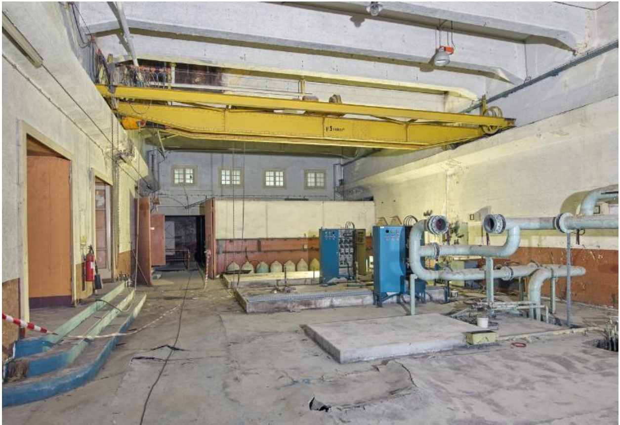
Vue de la salle des groupes électrogènes diesel : extrémité est (production d'air comprimé). Sur son chemin de roulement, le pont roulant d'une capacité de 5 tonnes. Les quatre fenêtres correspondent à deux bureaux situés au premier étage
