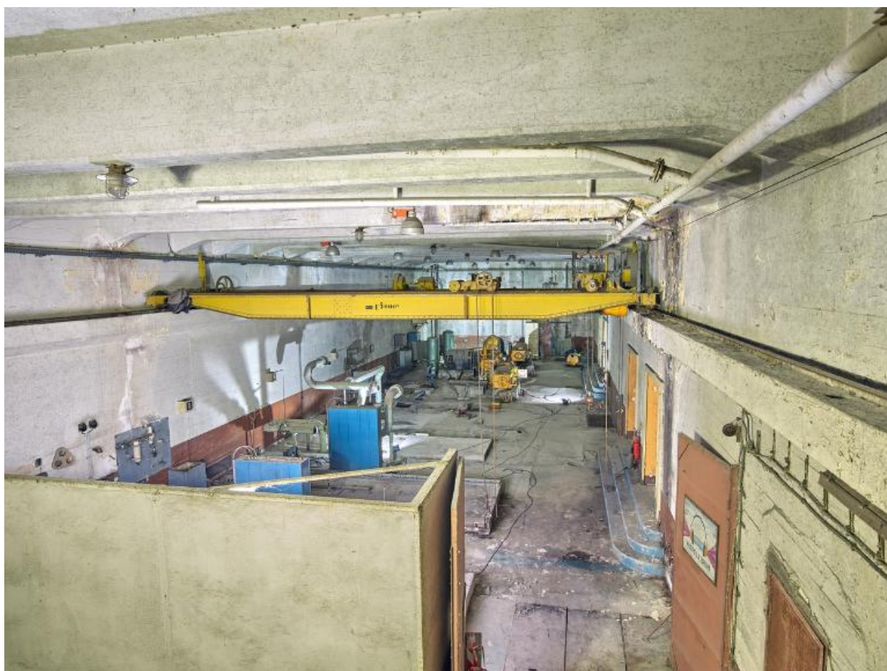
Vue de la salle des groupes électrogènes diesel depuis la fenêtre du bureau situé à l'est au premier étage
