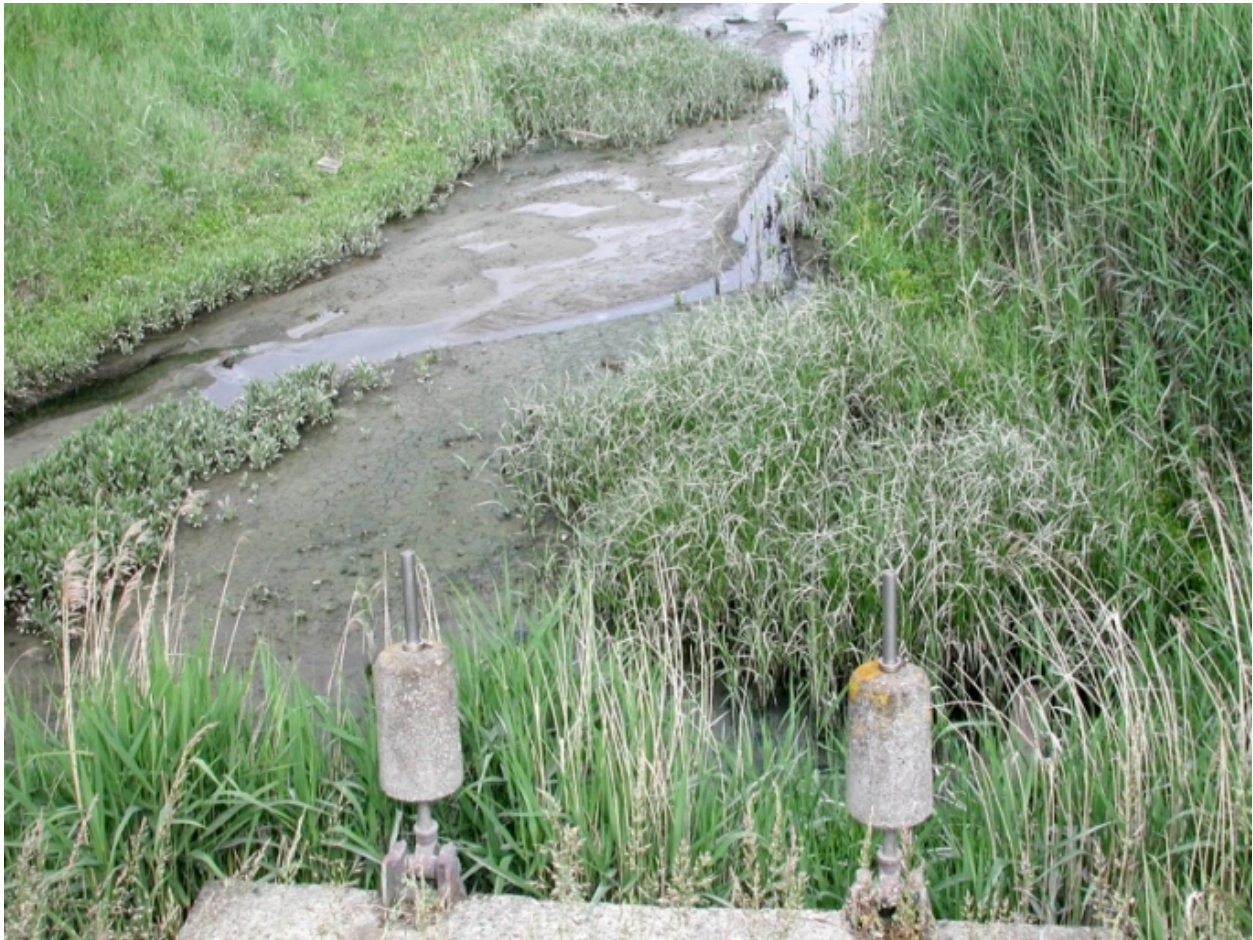
Double porte à marée du ruisseau La Corderie (rivière d'Yffiniac)
