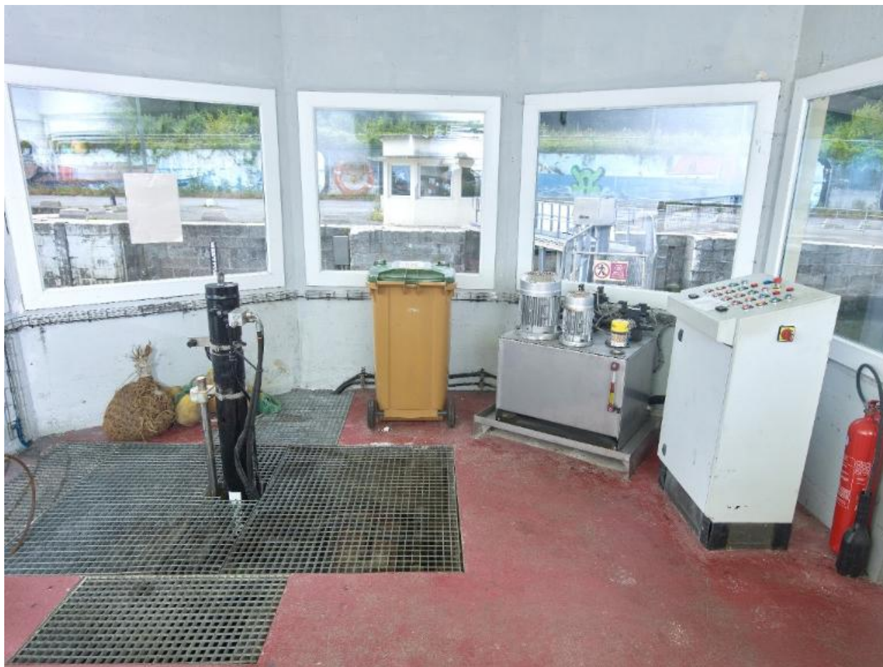
Vue d'ensemble de l'intérieur d'un des postes d'écluse
