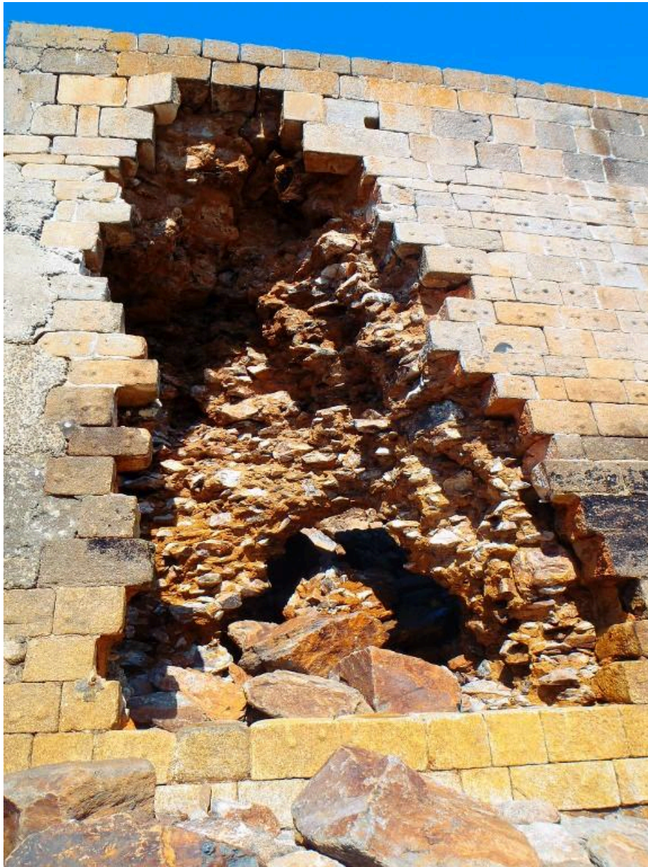
Vue de la brèche dans la batterie basse avant les travaux de consolidation, avril 2014
