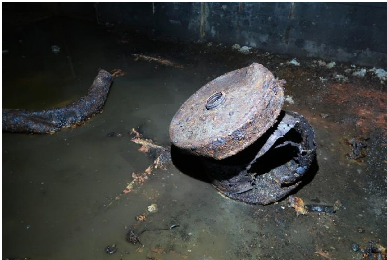
Vue de la salle de garde sud : au sol, baignant dans l'eau : filtre à charbon du ventilateur et tuyau de la ventilation
