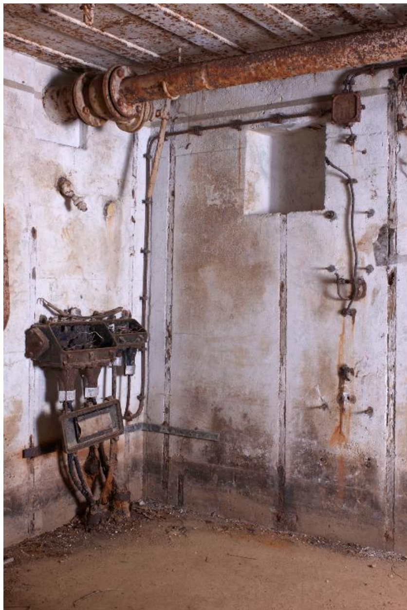
Vue de situation du boîtier de connexion téléphonique dans l'angle de la pièce, photographie réalisée le 11 mai 2009
