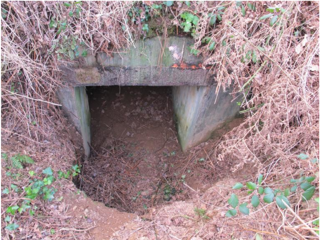
Vue de l'entrée est en partie remblayée et envahie par la végétation (état en 2013)
