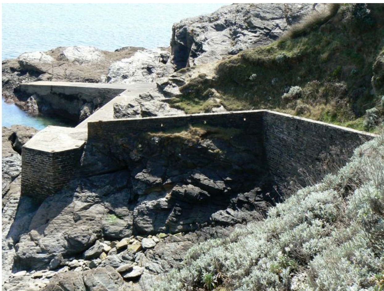
Muret protégeant le chemin d'accès à la cale et cale des Grands-Sables
