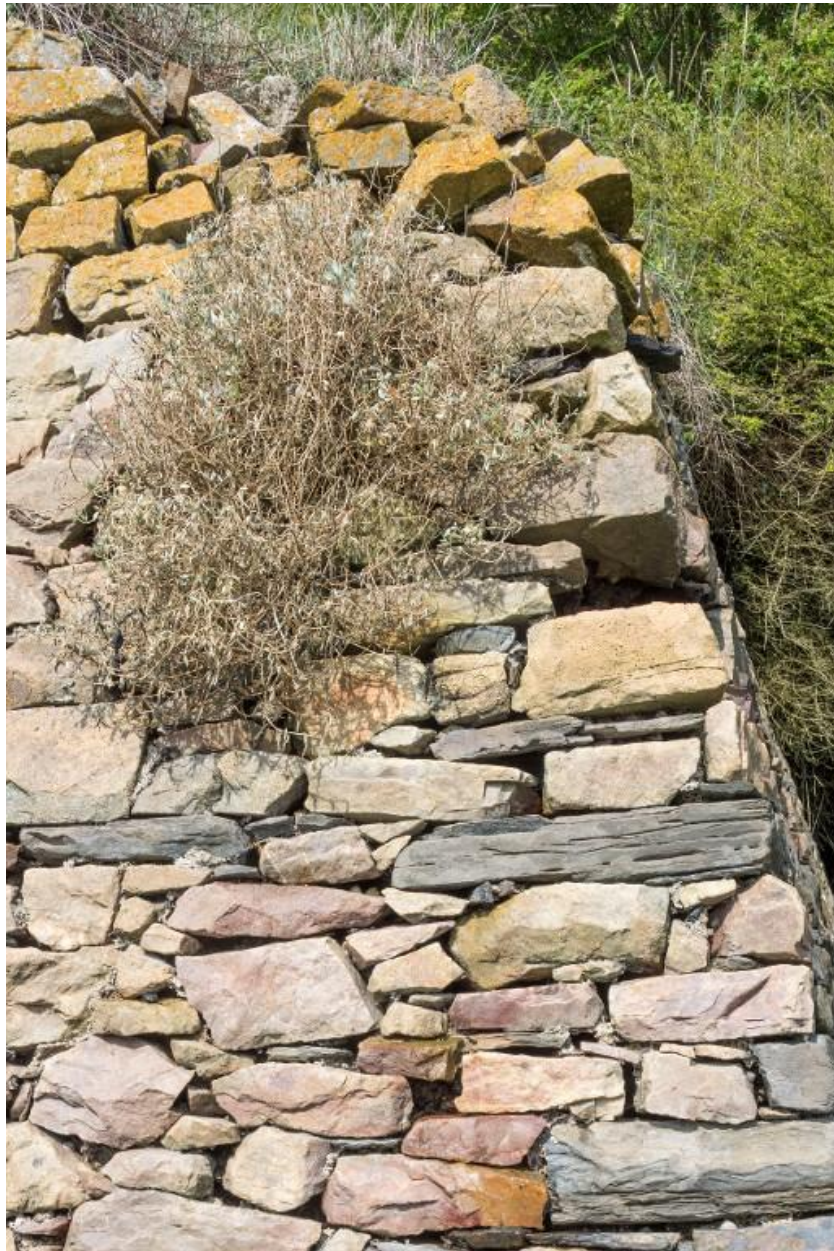
Détail d'obione ( Halimione portulacoides ) poussant sur le parement de la cale du four à chaux de Plouguiel
