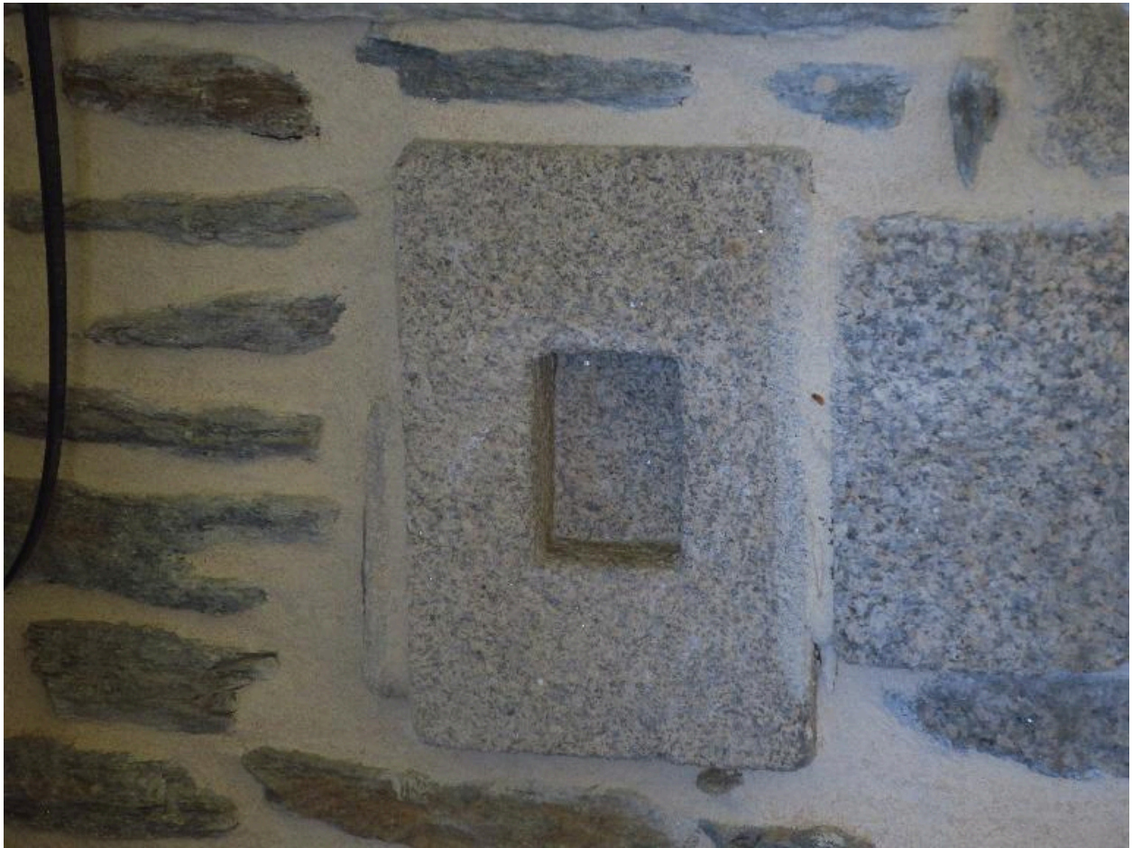
Groix, batterie de Nosterven, corps de garde crénelé, encoche pour barre d'accrochage de hamacs.
