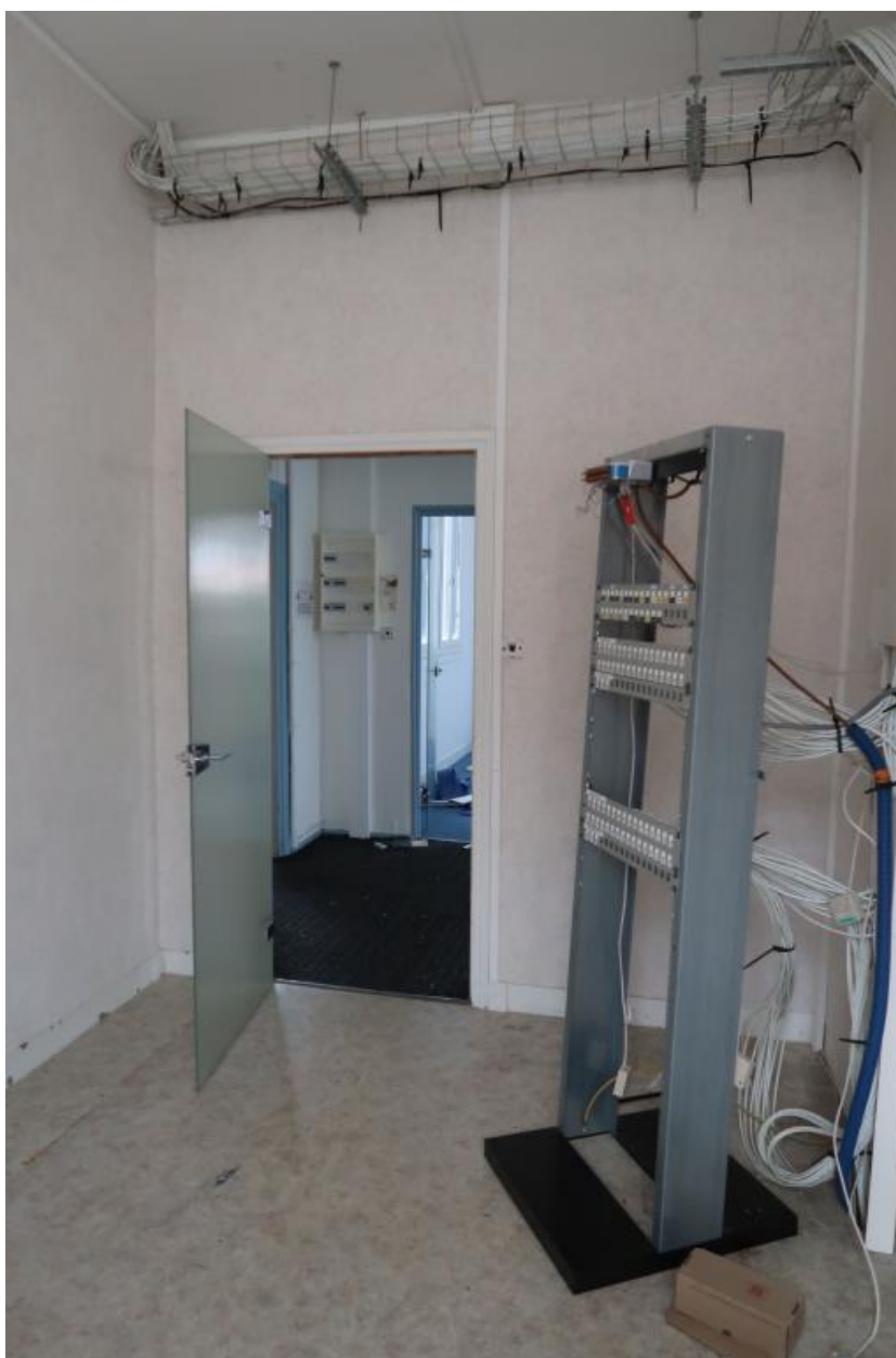
Intérieur, 1er étage, local des baies informatiques
