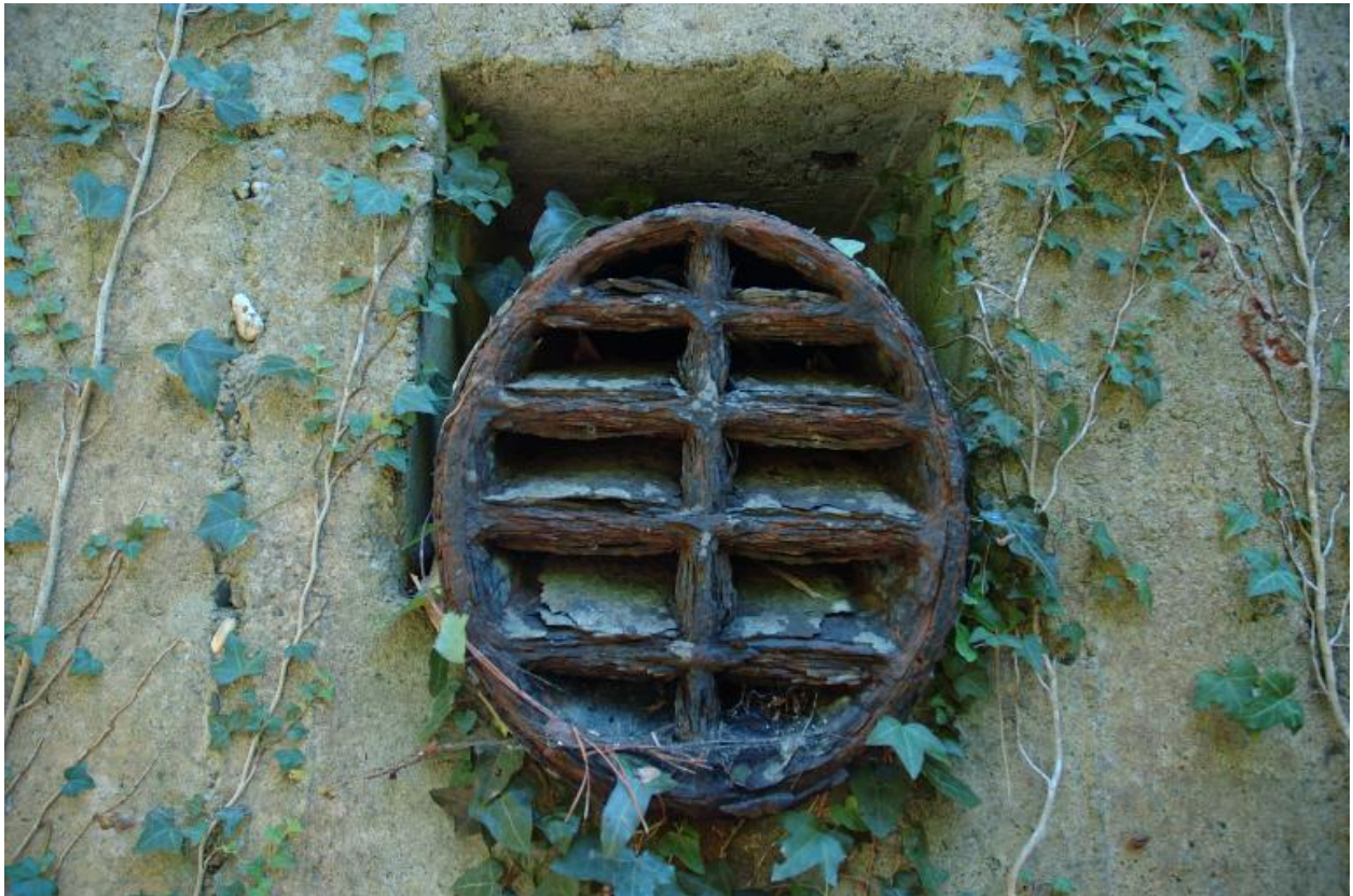
Vue d'une grille de ventilation (état en 2005)
