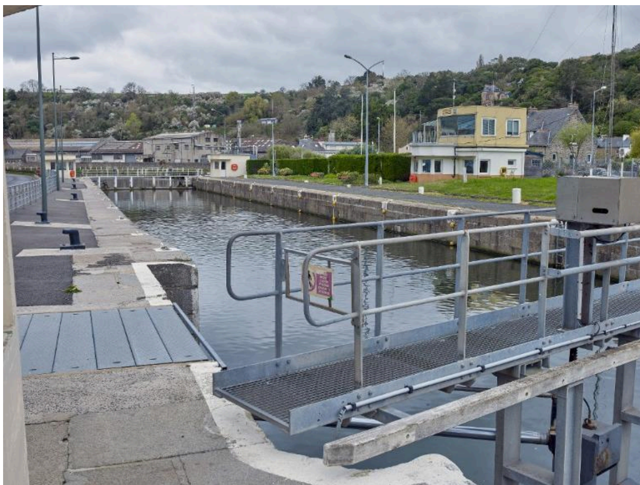
Passerelle et sas de l'écluse
