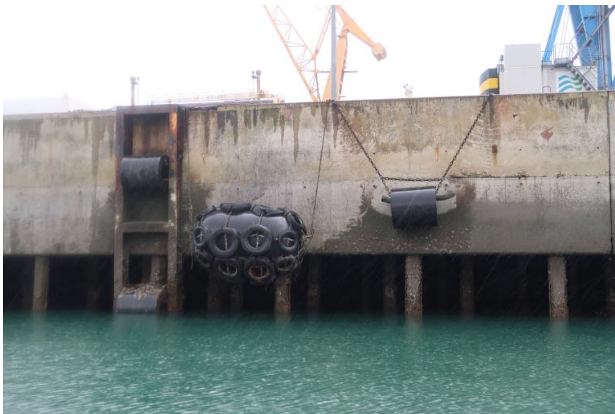
Quai réparation à flot, défenses d'accostage
