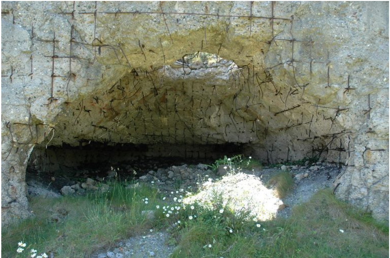
Vue de l'une des cuves pour canon de 22 cm (état en 2005). Bunker - abri après une explosion intérieure
