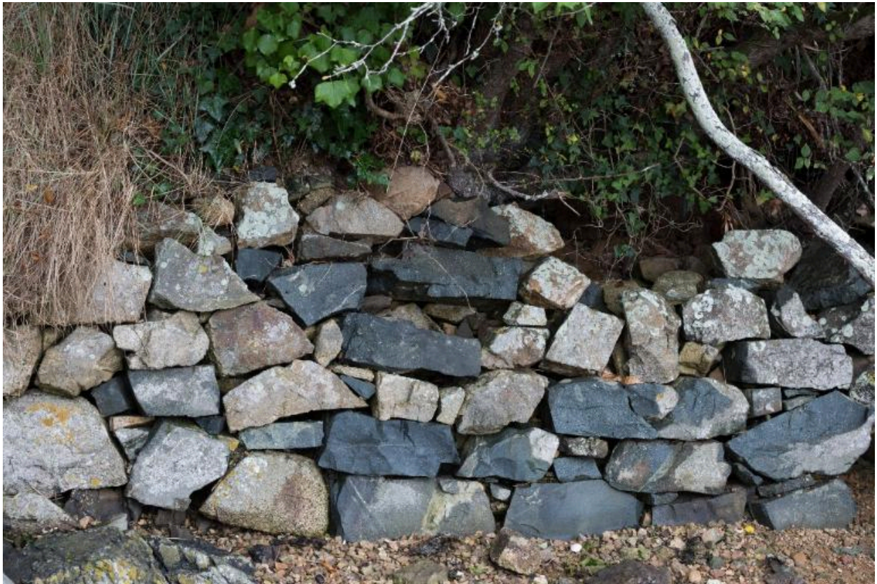
Vue d'un mur de soutènement aux moellons fragilisés, au niveau de la baie de l'Enfer
