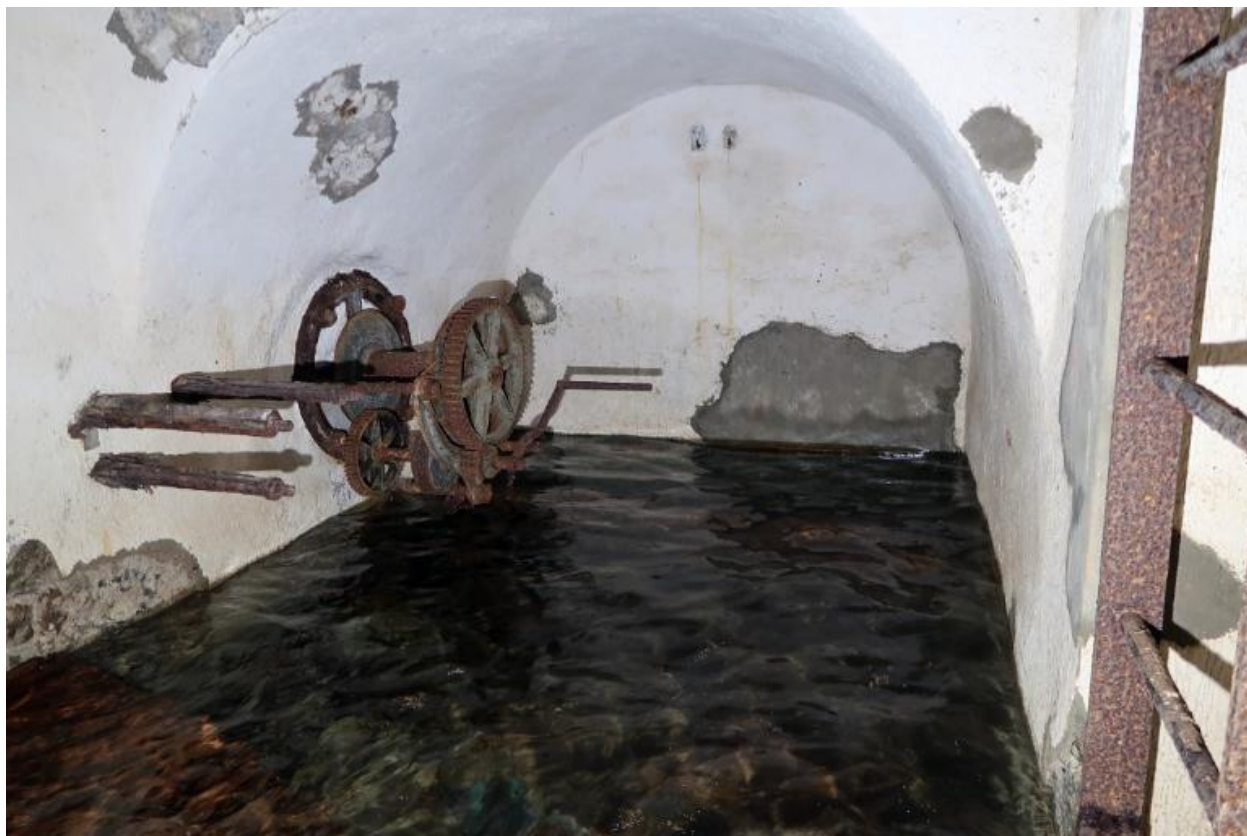
Vue de la chambre du treuil manuel à tambour du monte-charge
