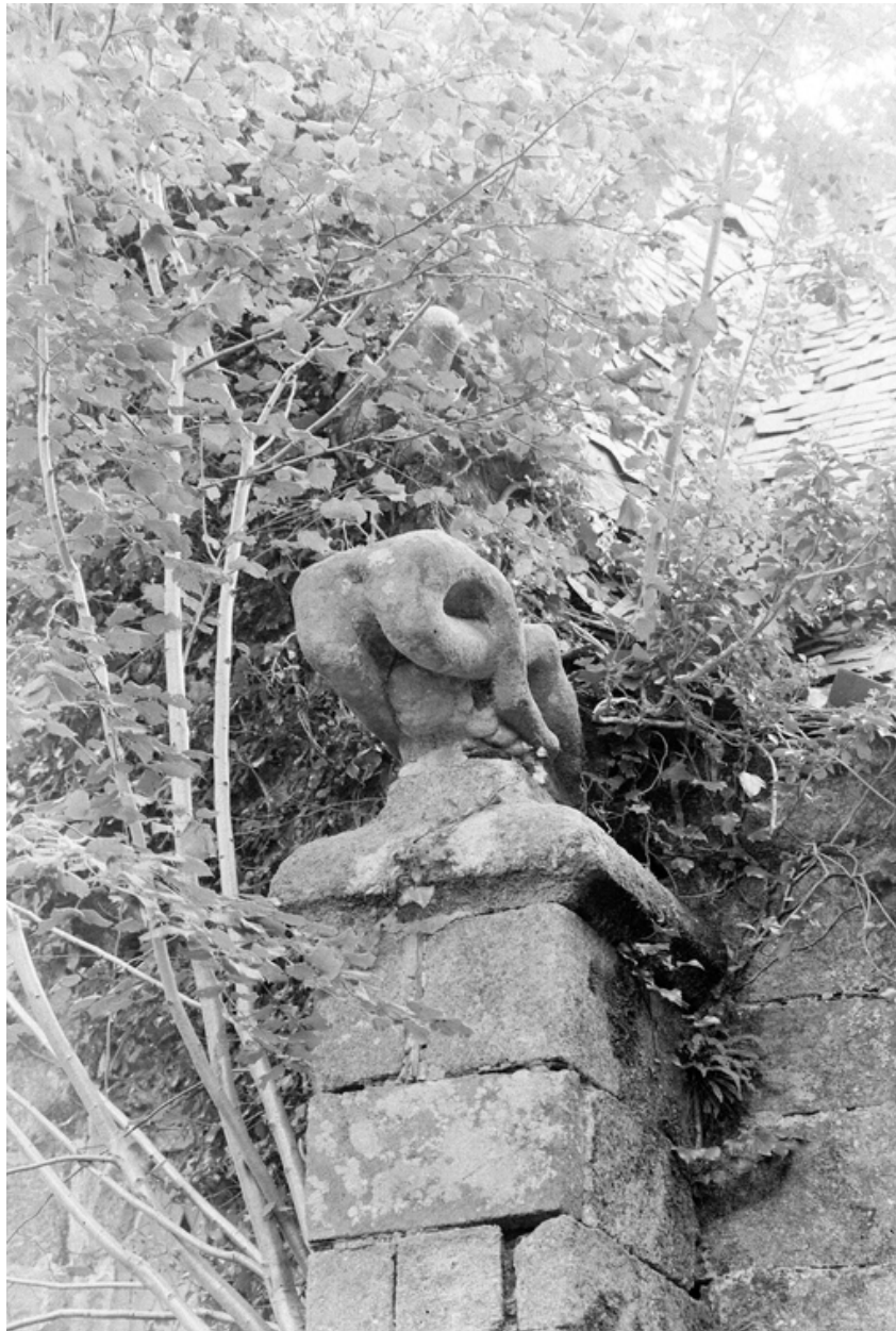
Contrefort nord du chevet, détail : vue de la gargouille (vue de face)
