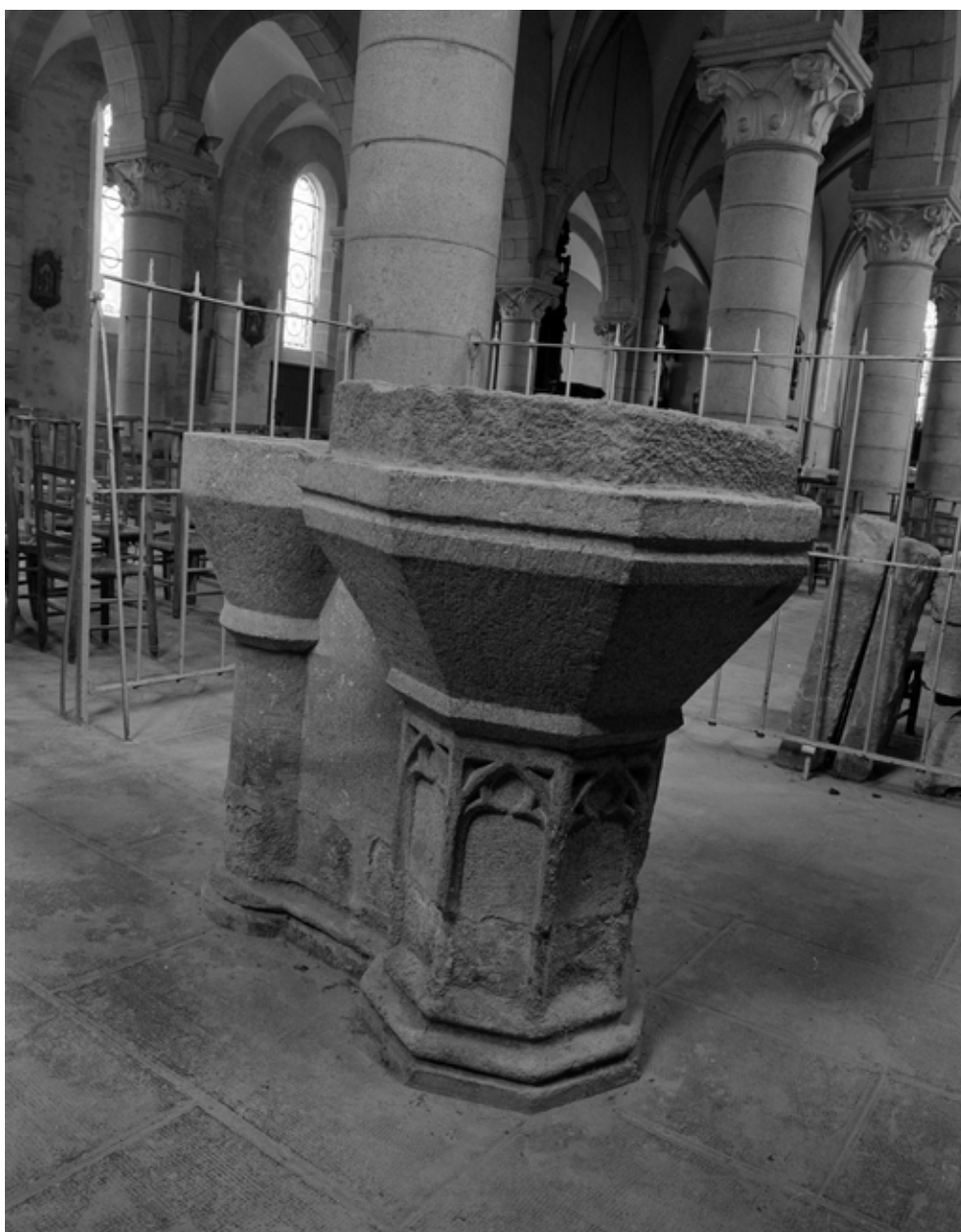
Cuve, vue générale.
