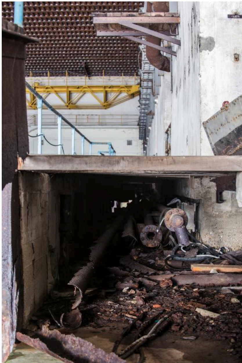
Vue des tuyaux passant sous le platelage en bois du quai central de l'alvéole nord. Les fluides étaient destinés à avitailler les sous-marins à quai
