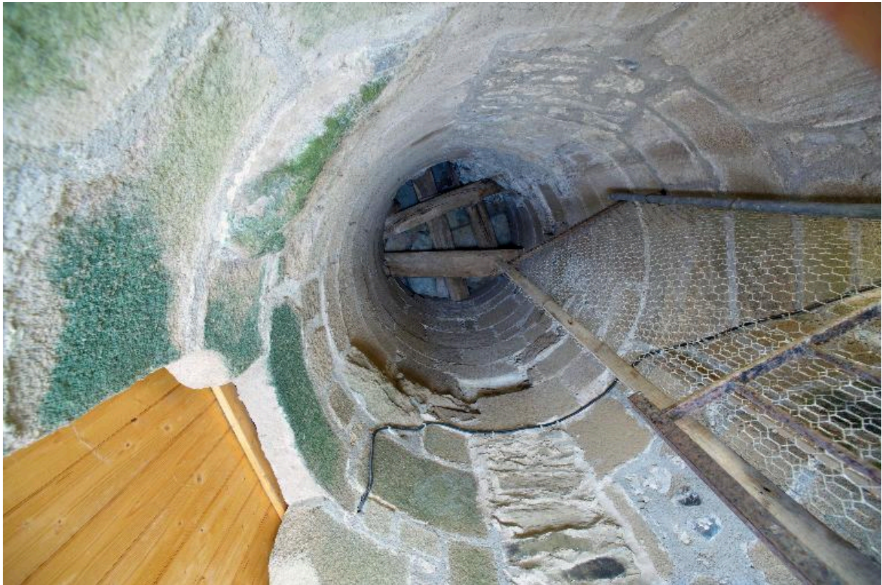
Massif nord-ouest, escalier en vis, vue vers le sommet avec traces de marches arrachées.
