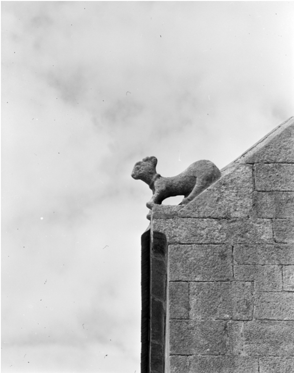
Plomodiern, église paroissiale Saint-Mahouarn : façade sud, pignon du transept, crossette gauche, état en 1972
