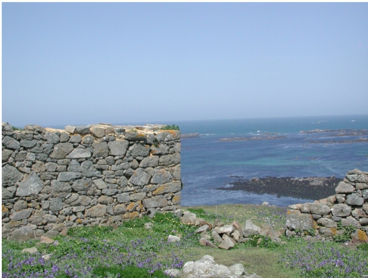
Rupture dans la continuité du muret défensif
