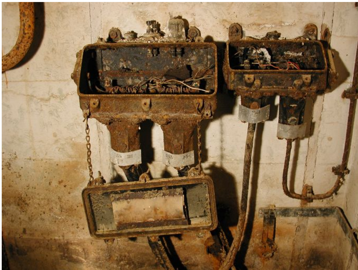
Vue du boîtier de connexion téléphonique : intérieur (lignes 285, 284, 283)
