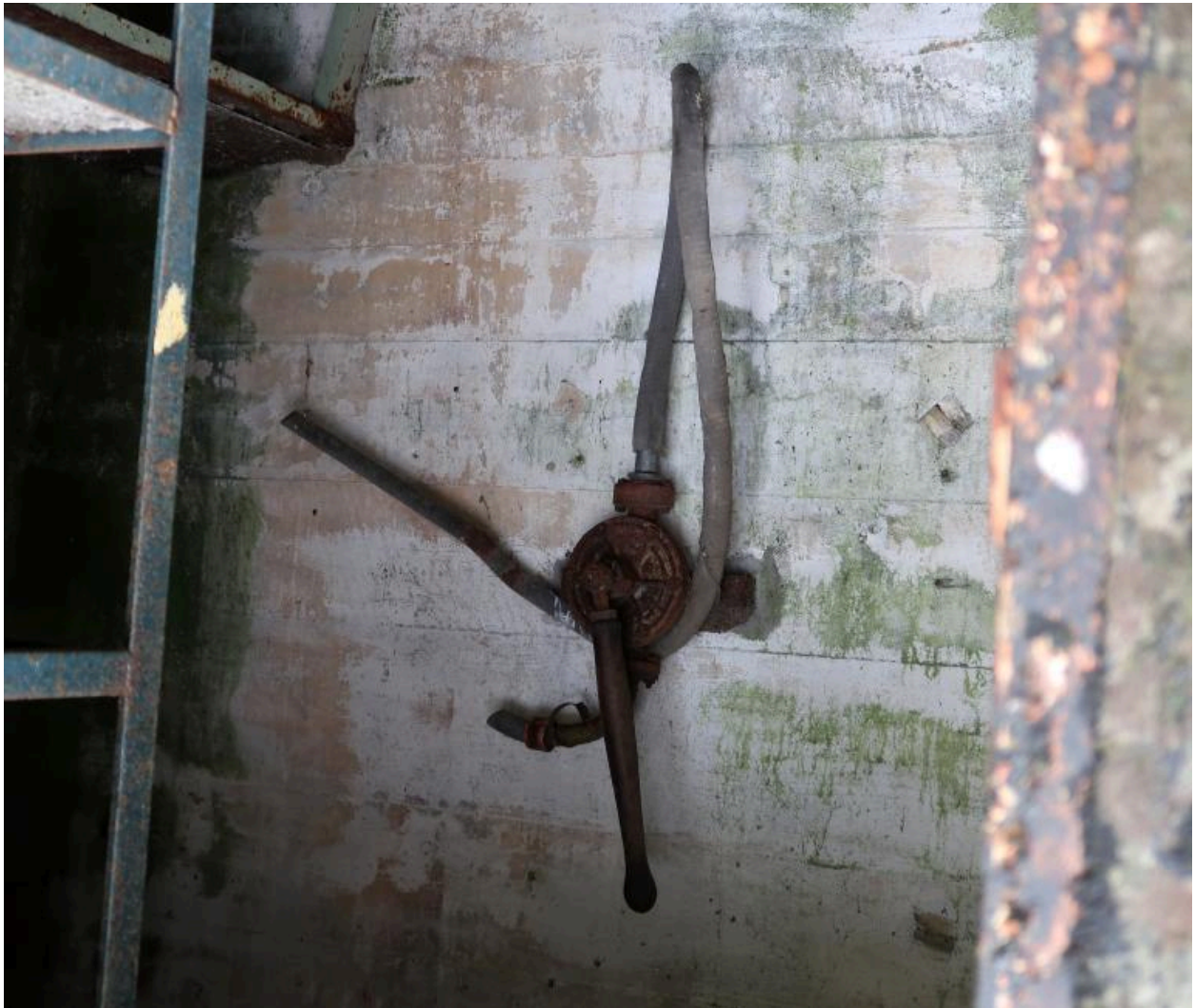
Vue de la vanne (ou pompe de transfert ?) fixée sur le mur extérieur nord du bunker
