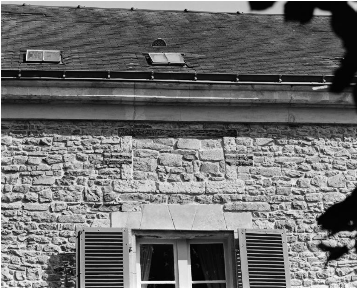
Elévation ouest, première travée nord, détail : fenêtre bouchée.
