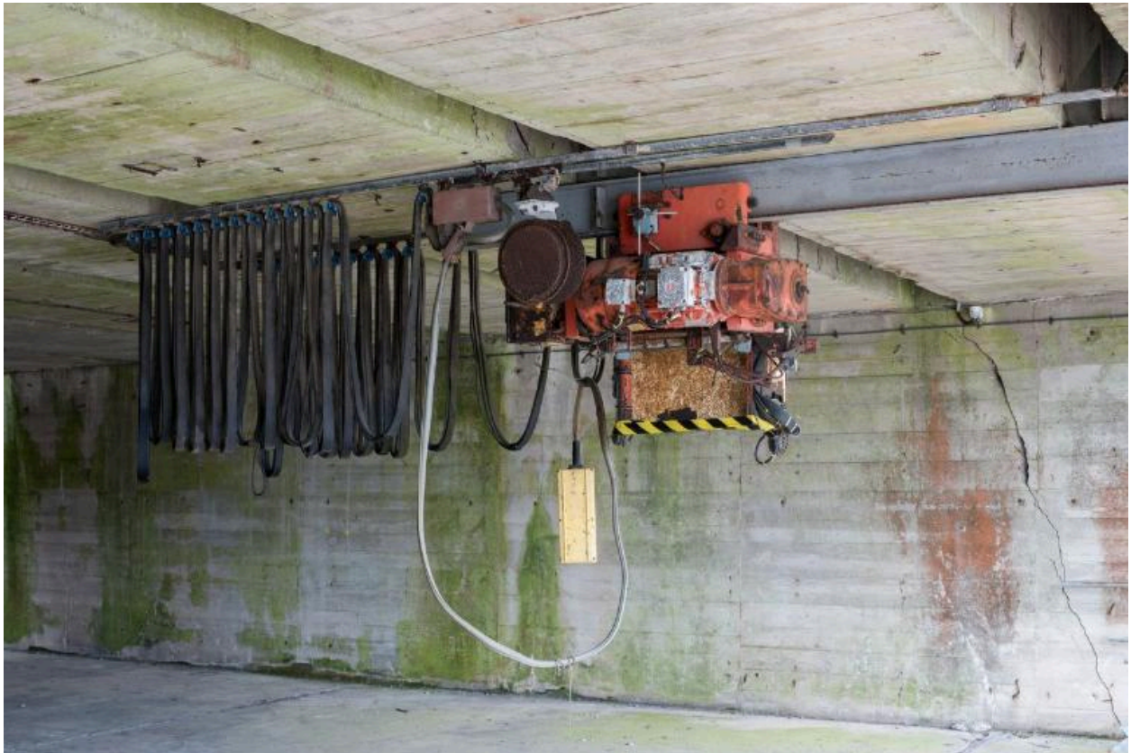
Vue d'un treuil français disposé dans l'une des chambres d'explosion
