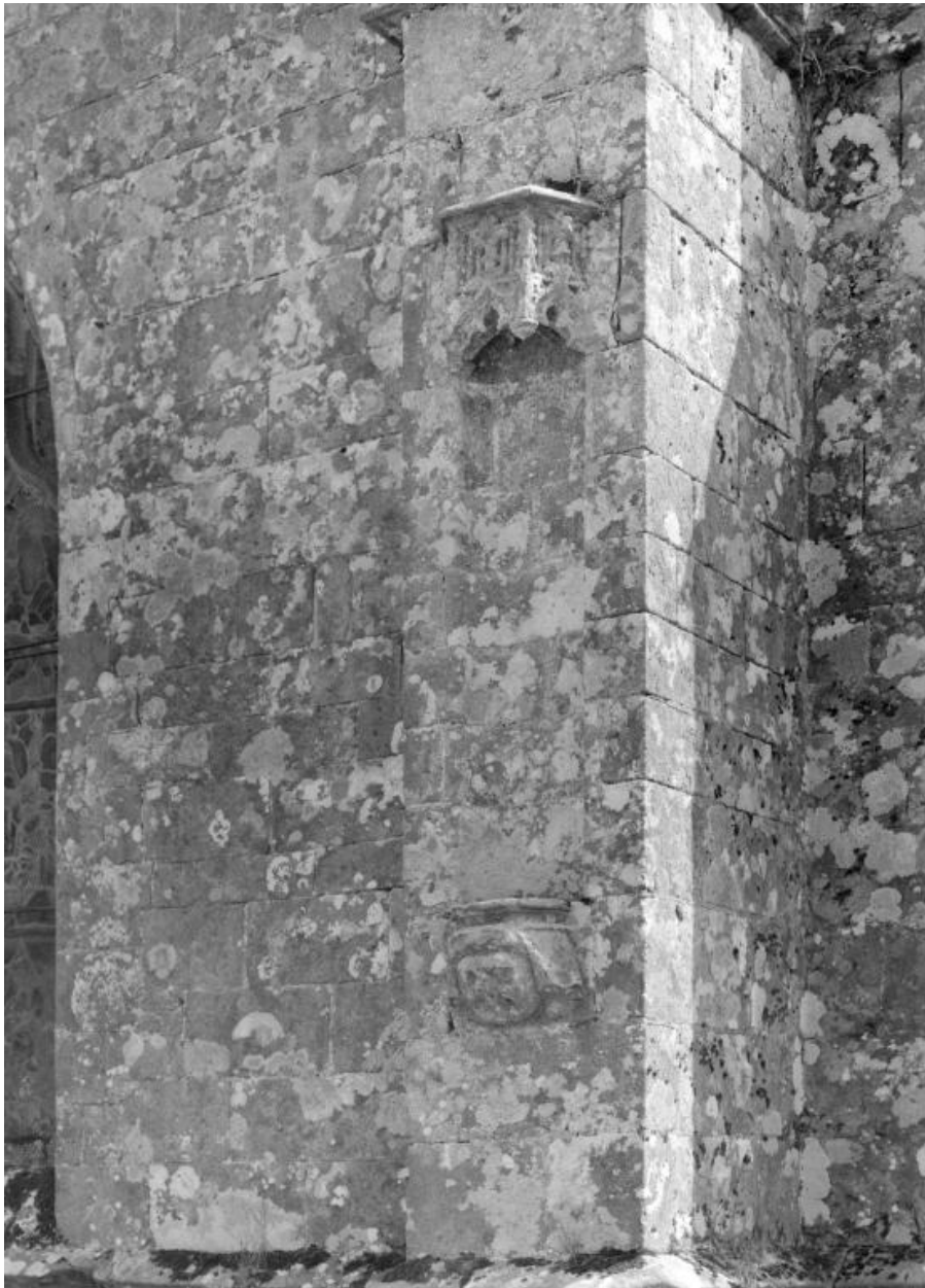
Niche du contrefort nord-ouest du bras du transept nord (perpendiculaire au mur nord).
