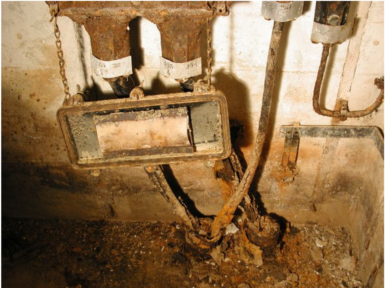
Vue du boîtier de connexion téléphonique : détail (lignes 285, 284, 283)
