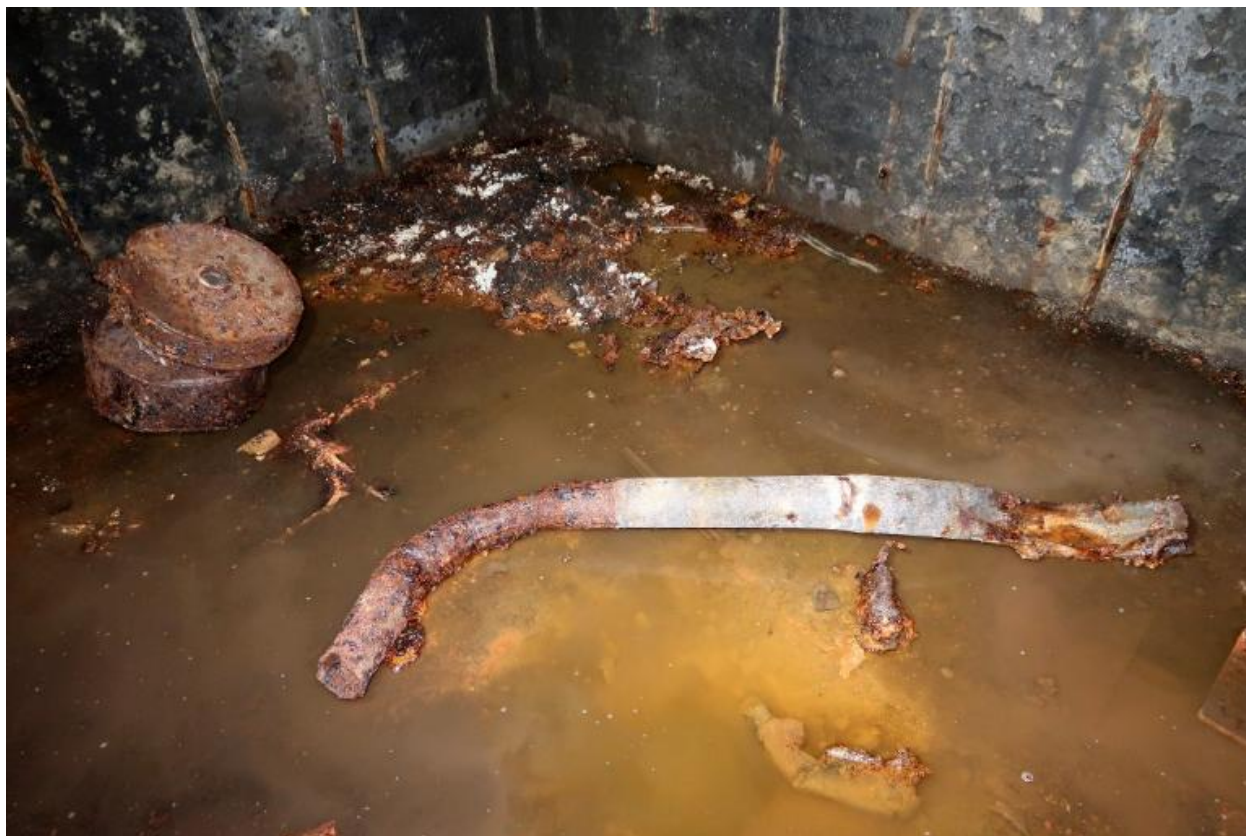
Vue de la salle de garde sud : au sol, baignant dans l'eau : tuyau de la ventilation et filtre à charbon du ventilateur
