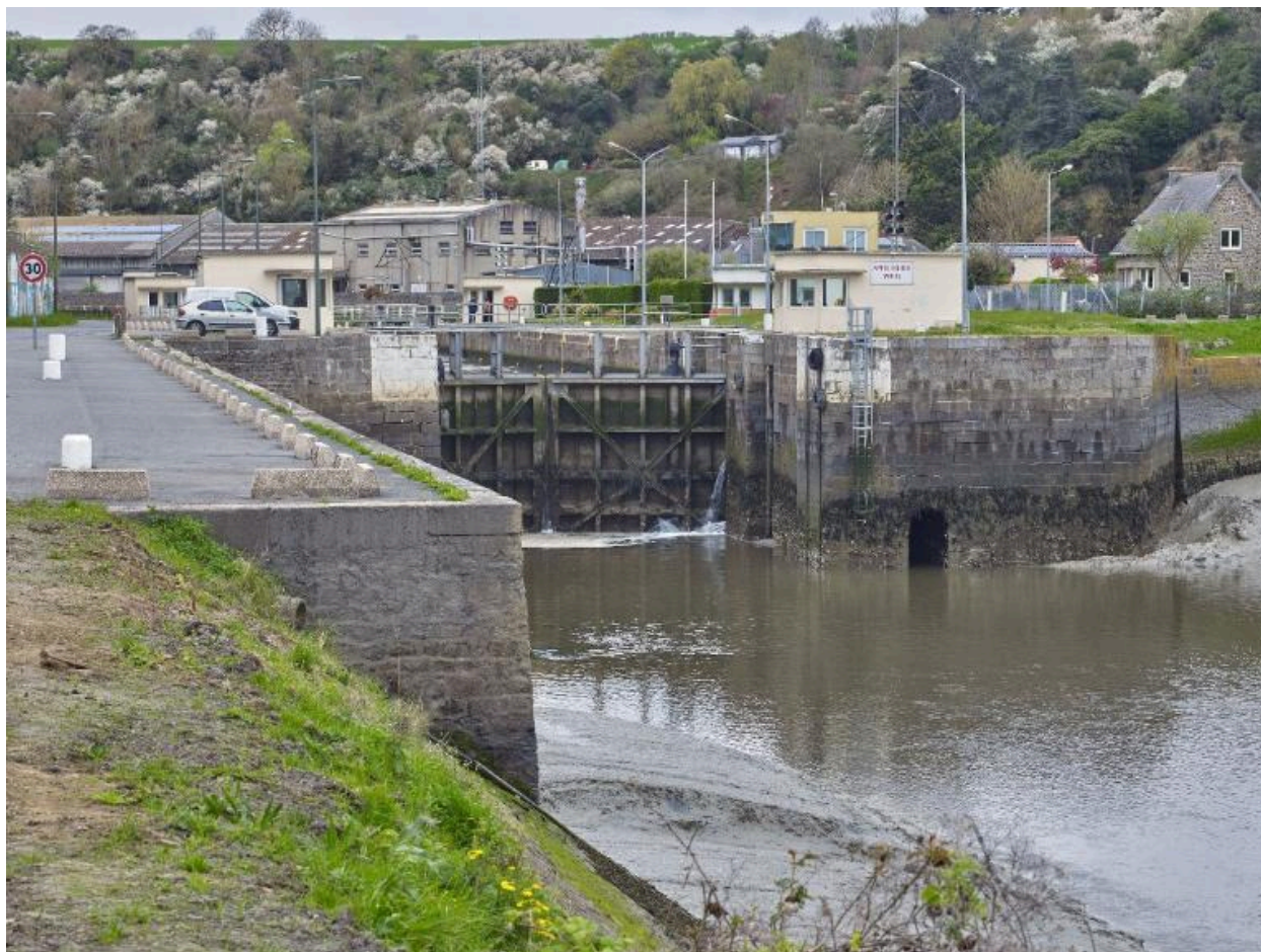
Vue de situation de l'écluse en aval depuis les perrés et quai d'attente
