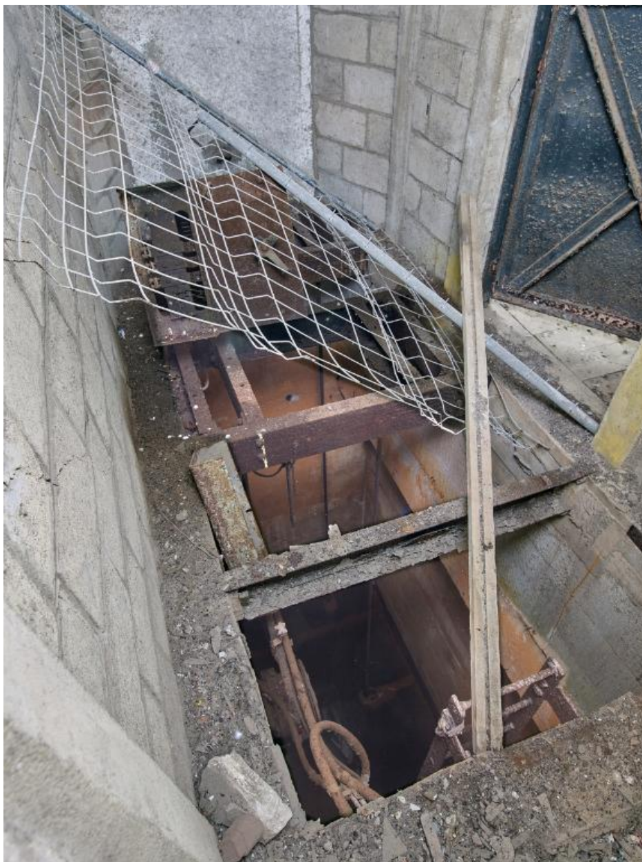
Vue de la salle des pompes de l'alcôve D (quai n° 19) aménagée dans l'épaisseur du mur de refend : fosse technique en sous-sol au niveau des commandes des pompes
