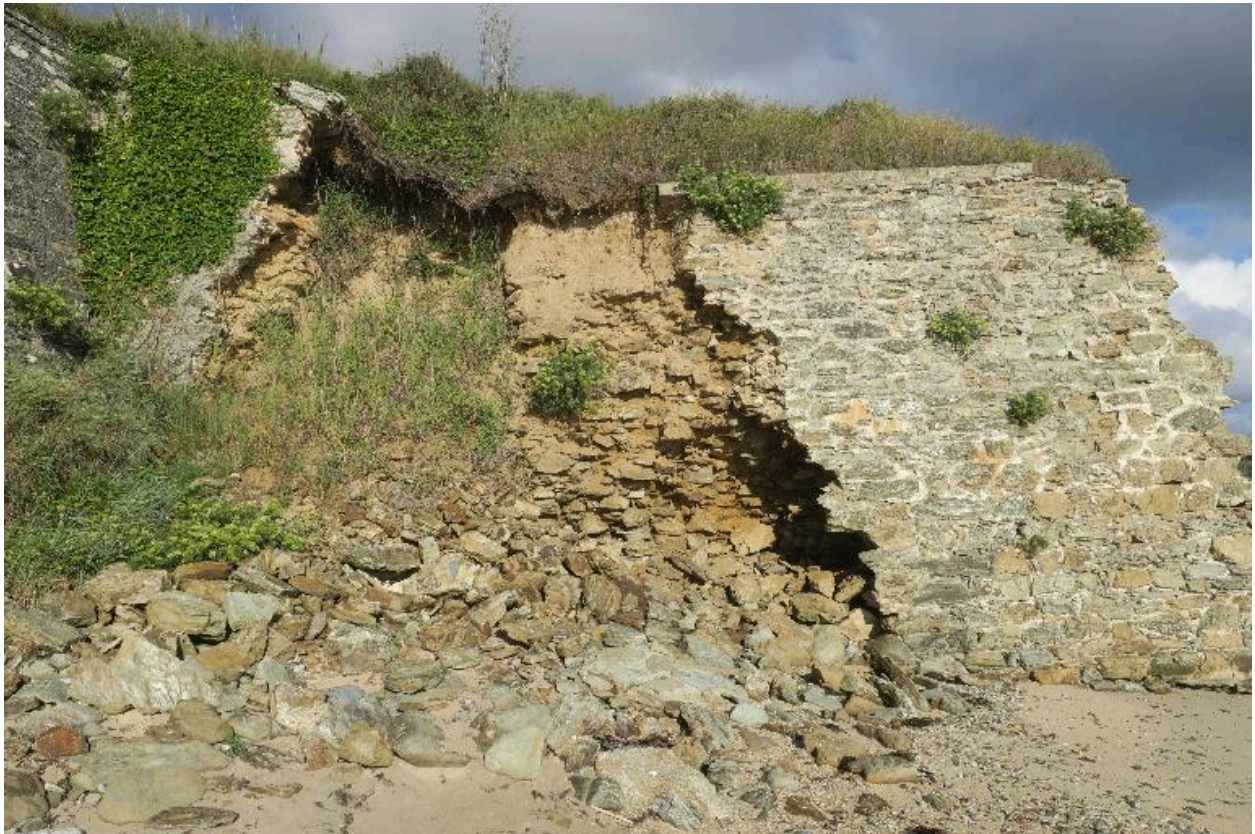
Locmaria, Grands Sables, dégâts sur l'escarpe.
