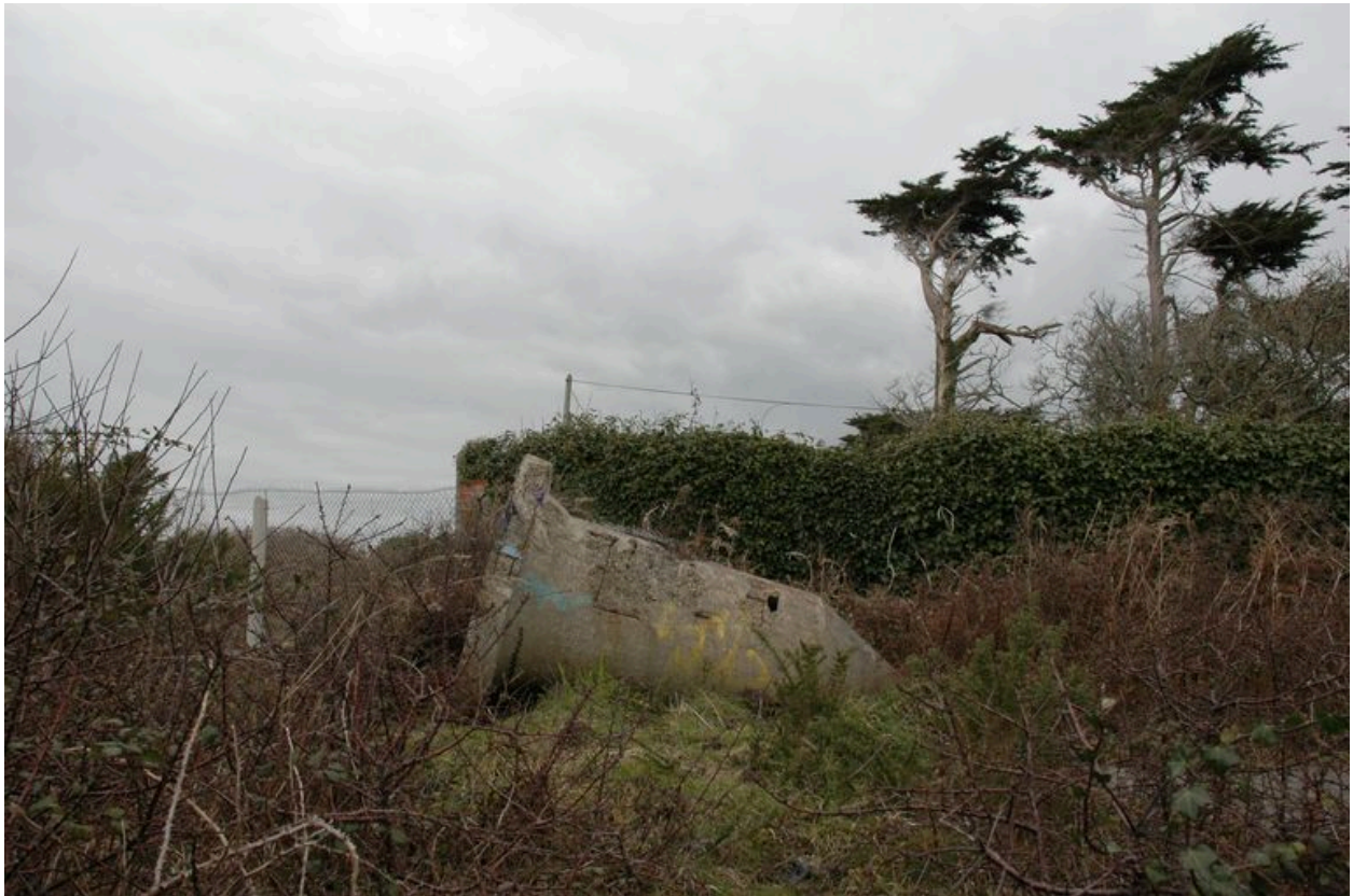
Vue de situation de la guérite en béton armé : elle est basculée (état en 2005)
