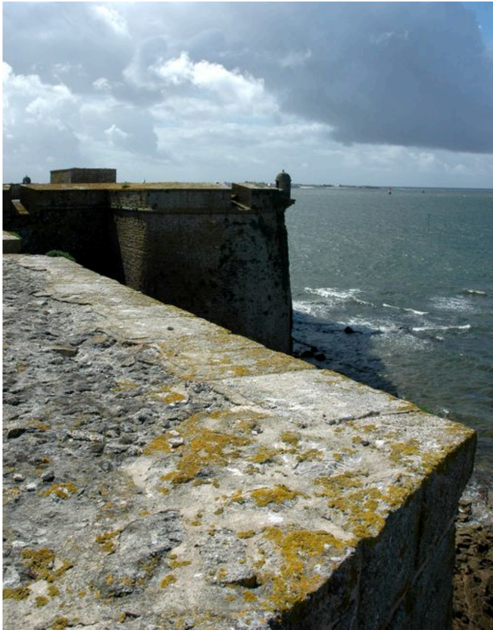
Vue de la citadelle de Port-Louis : embrasures plongeantes et échauguette du bastion à orillon des Chambres
