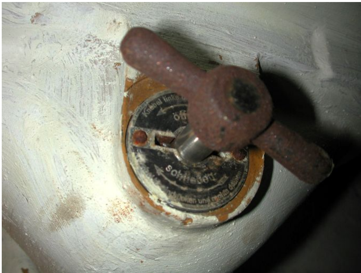
Vue intérieure : plaque constructeur du filtre dépoussiéreur du système de ventilation (état en 2003)
