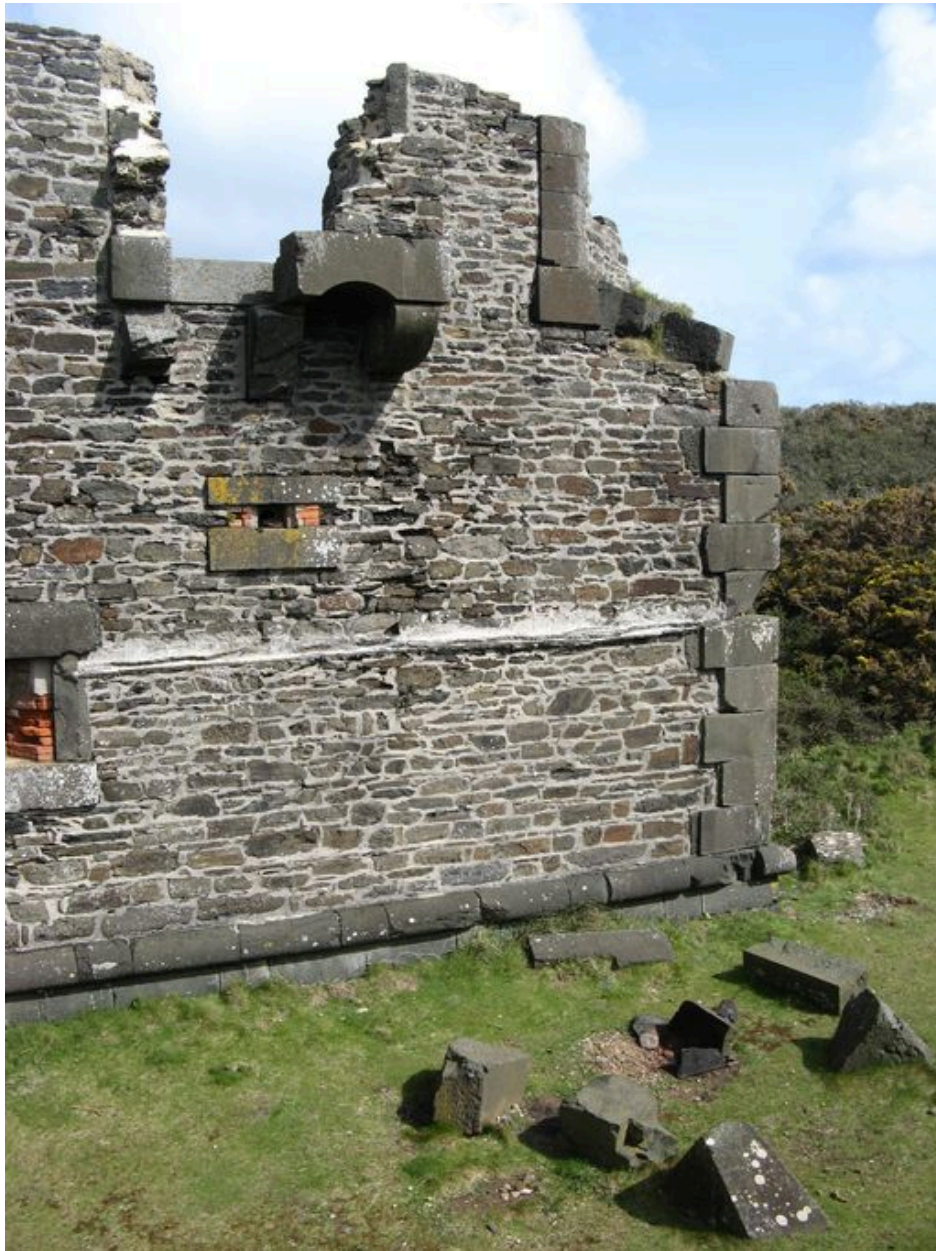
Balustrade effondrée du fort de l'Aber
