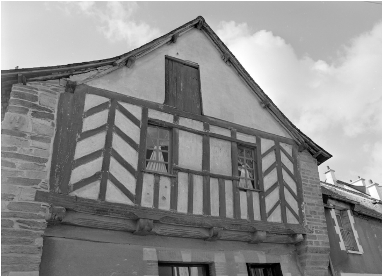
Maison 16 rue aux Roux, élévation nord : détail du pan de bois en encorbellement.
