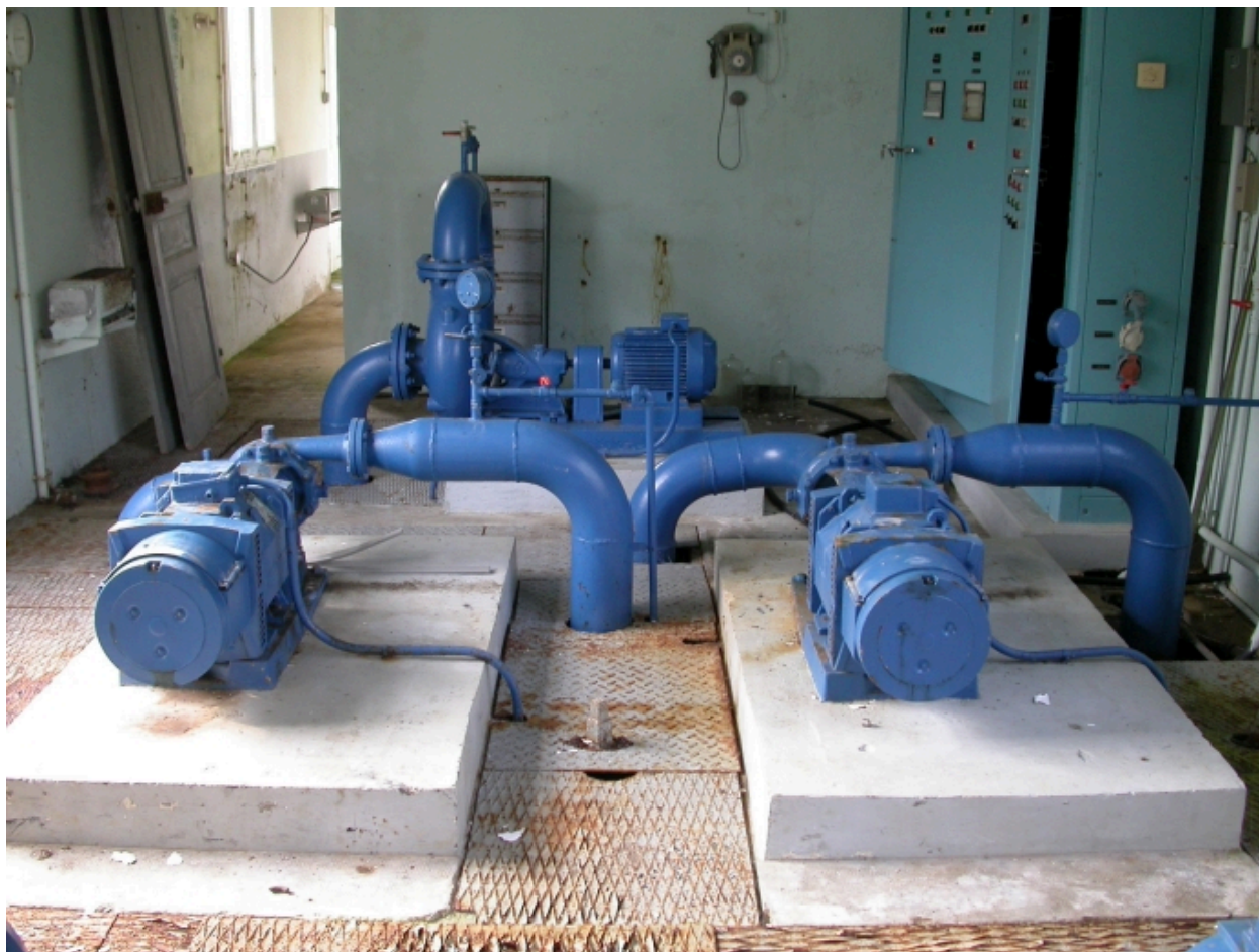
Les pompes du service bas et la pompe de lavage pour les filtres (au fond).
