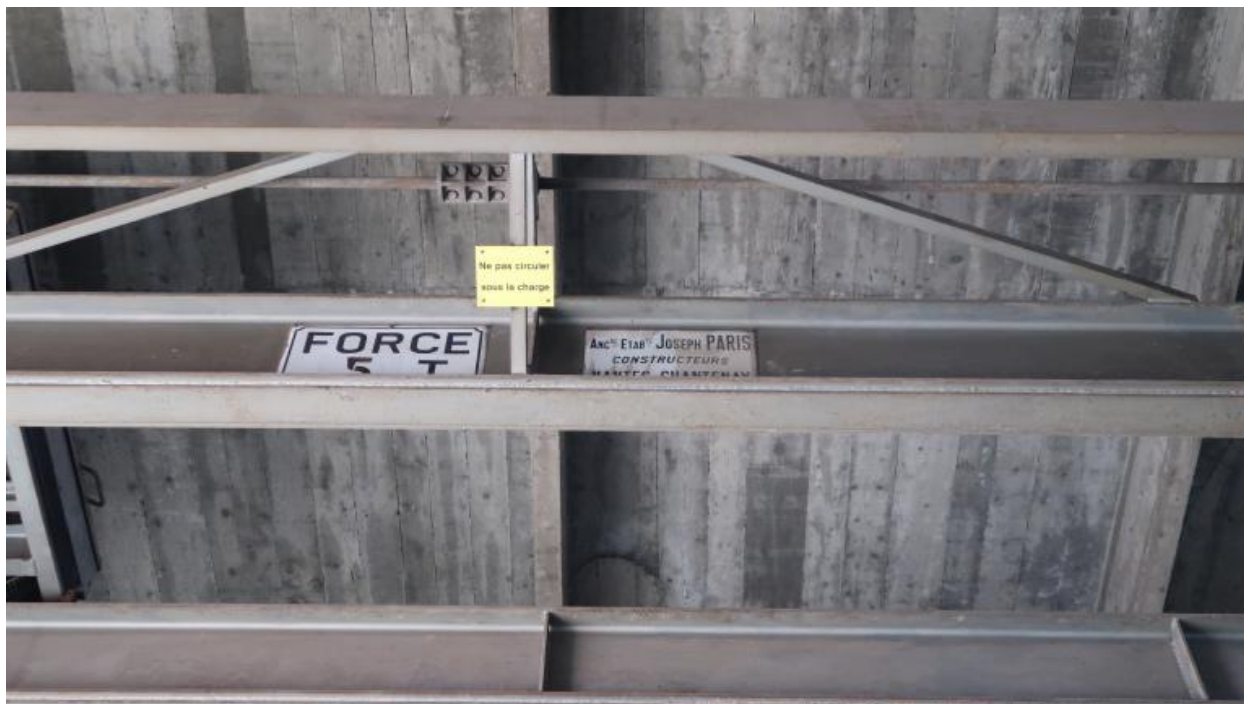
Pont roulant, établissement Joseph Pairs
