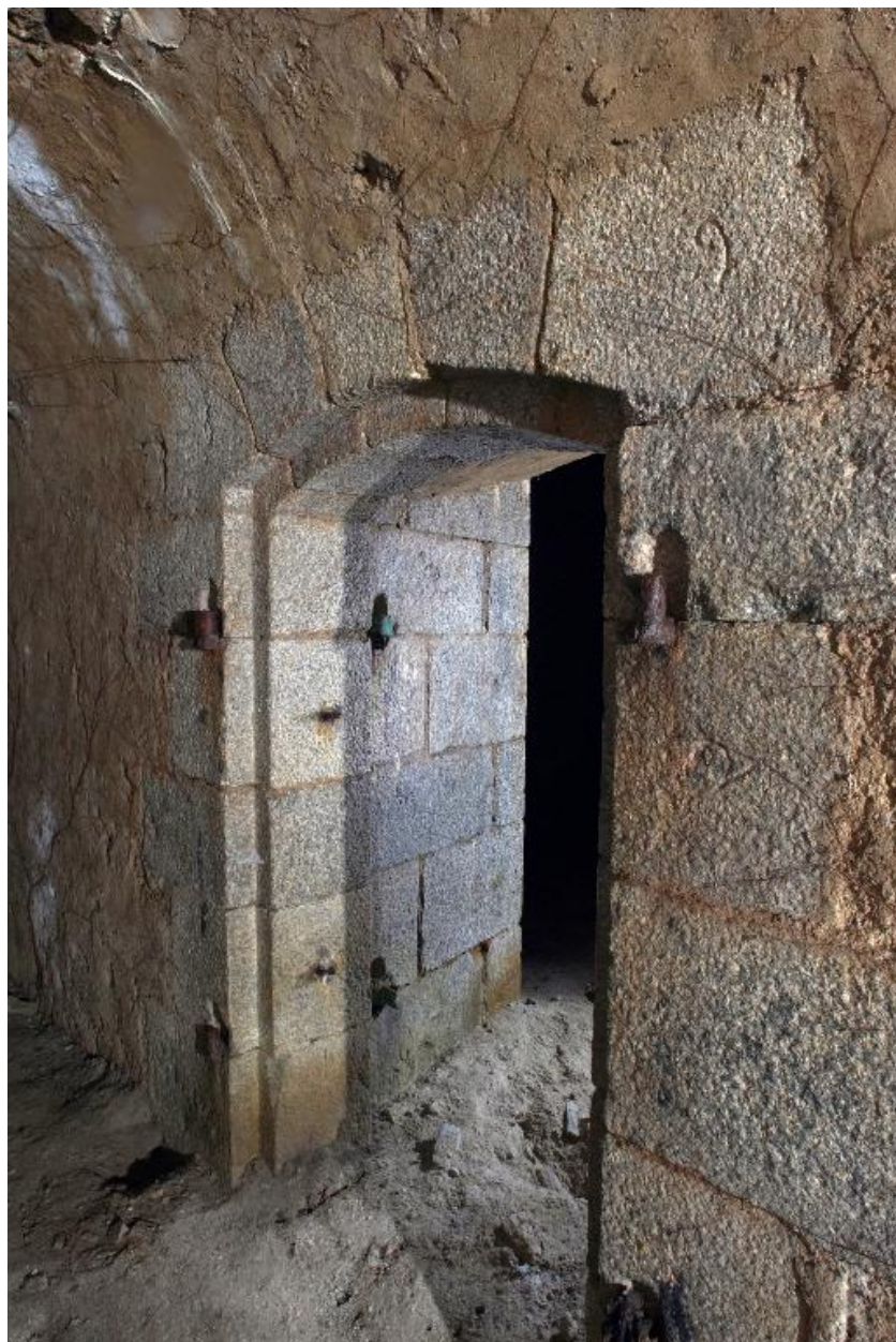
Brest : le fort de Penfeld, magasin à poudre, porte, piédroit portant des marques de tâcheron, photographie réalisée le 13 mai 2009
