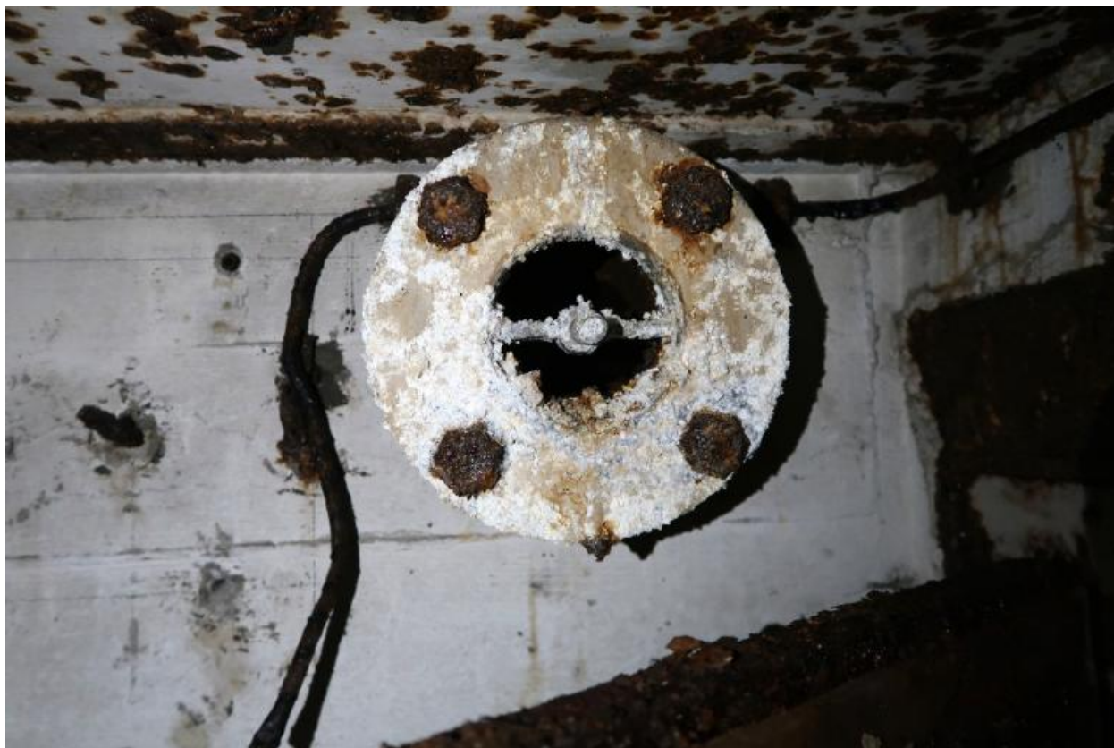
Vue intérieure : petite pièce située au nord-est, bouche de soufflage à vis réglable
