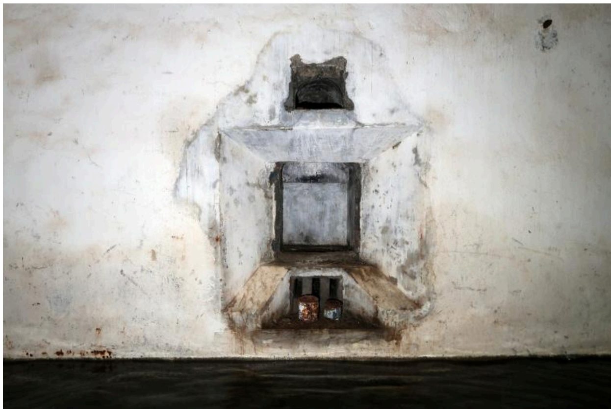
Vue du créneau à lampe. Le magasin est partiellement inondé
