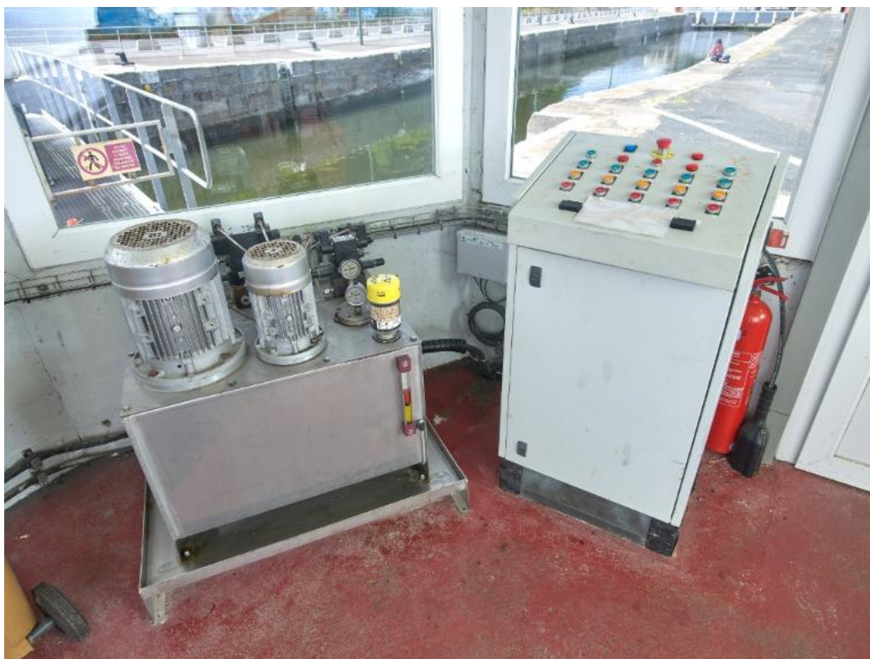
A l'intérieur du poste d'écluse : commandes des vannes et vanteaux et moteur du système hydraulique
